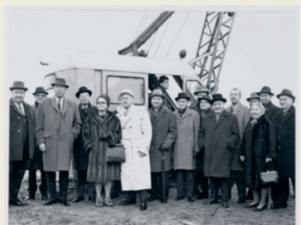
Koos Pot-Keegstra (vijfde van links) bij het slaan van de eerste paal van het bejaardentehuis aan de C. Outshoornstraat in Amsterdam (1966)
